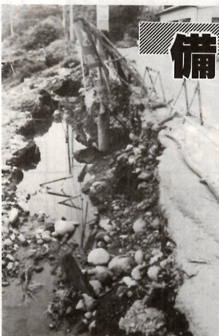
集中豪雨による路肩崩壊 上細井町で
